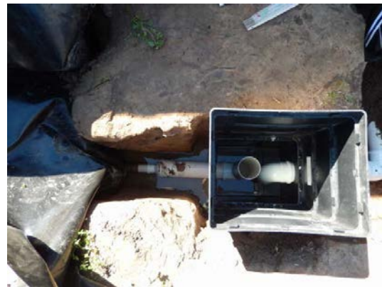
Figura 14: Conexão de saída e monjolo para controle de nível no interior do módulo II – WCH.
