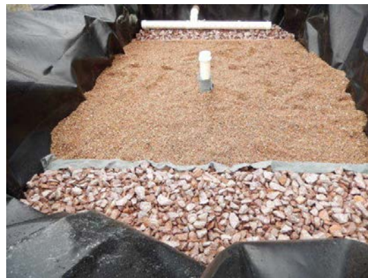
Figura 6: Sistema de alimentação do módulo II – WCH ainda aparente.
