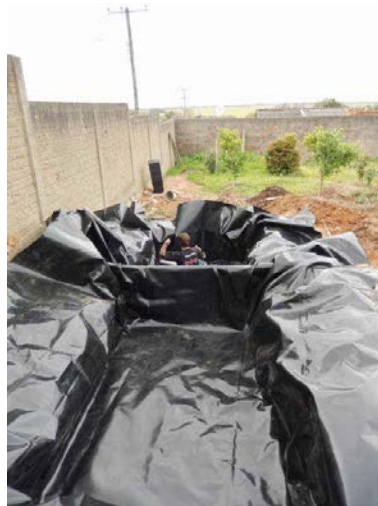
Figura 2: Tanque com geomembrana para impermeabilização.
