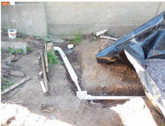
Figura 13: Conexão de entrada do wetland construído híbrido.
